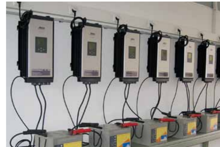
Batterieladegeräte im Einsatz
